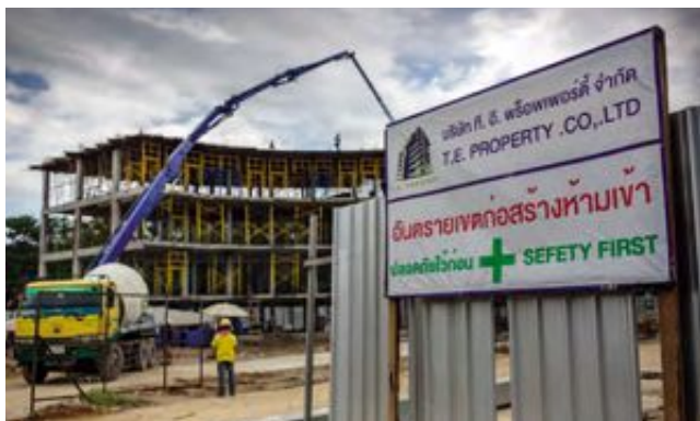
"Safety first". På skylten till arbetsplatsens entré ska det stå "Säkerheten först" – men det är felstavat.
